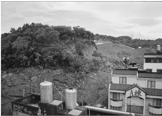
照片 3 健康博市滑動體照片，照片右上方為崩崖及滑動面，右下方為受波及之教孝街 3 巷房舍。左側為侵入基地之滑動岩體，岩體上仍有基地後方產業道路柏油路面之遺骸。(照片位置參見圖 11)
